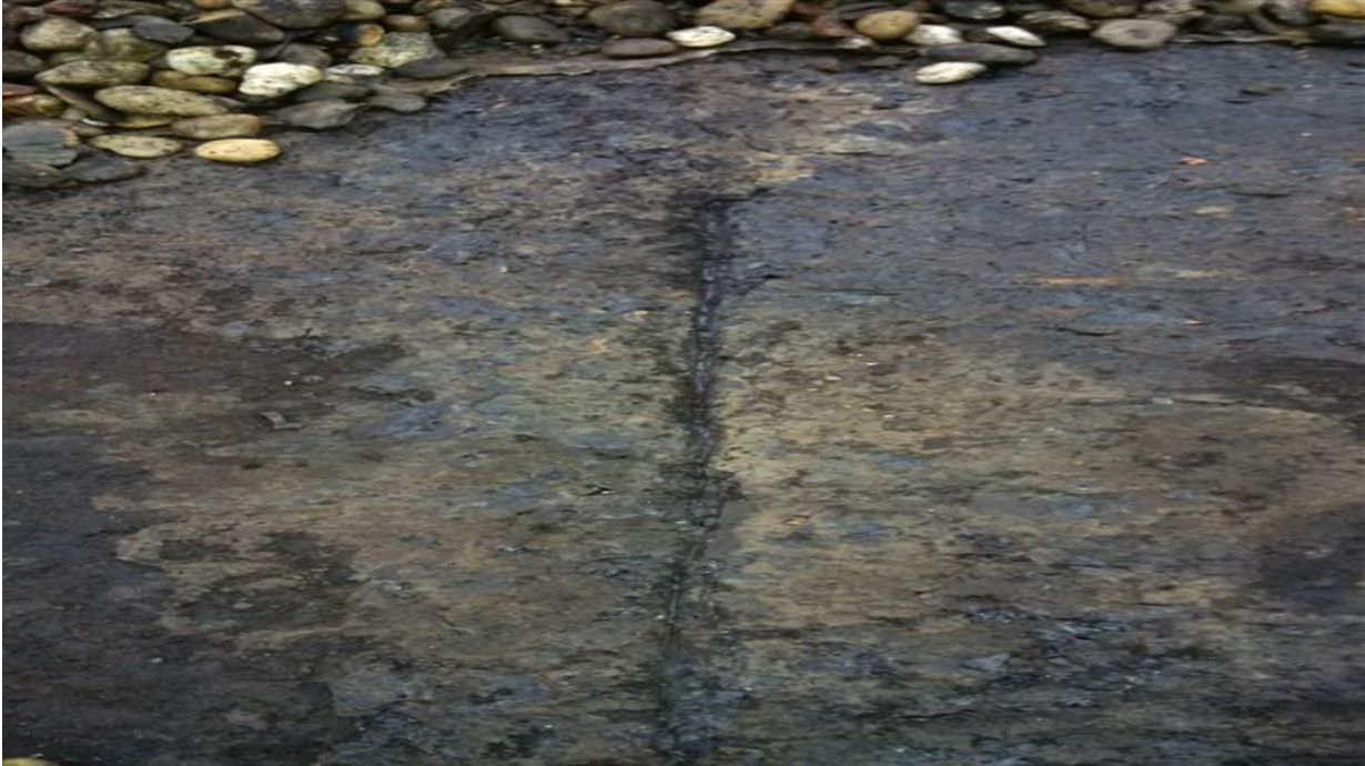
Ortungsfläche nach Entfernung der Auflast: Riss in der Dachhaut.
