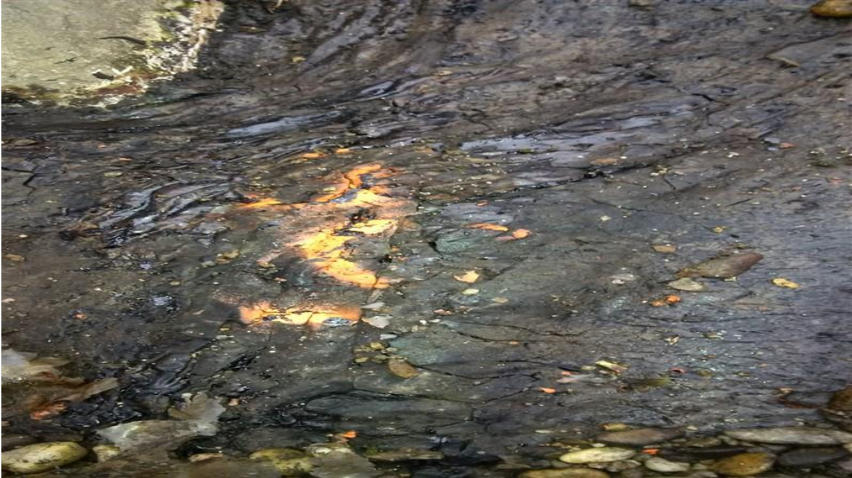
Ortungsfläche nach Entfernung der Auflast: Risse in der Dachhaut.
