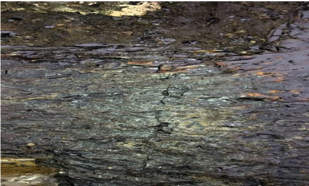
Ortungsfläche nach Entfernung der Auflast: Risse in der Dachhaut.
